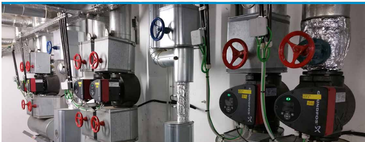
► Neue Hocheffizienzpumpen für die Heizkreise
