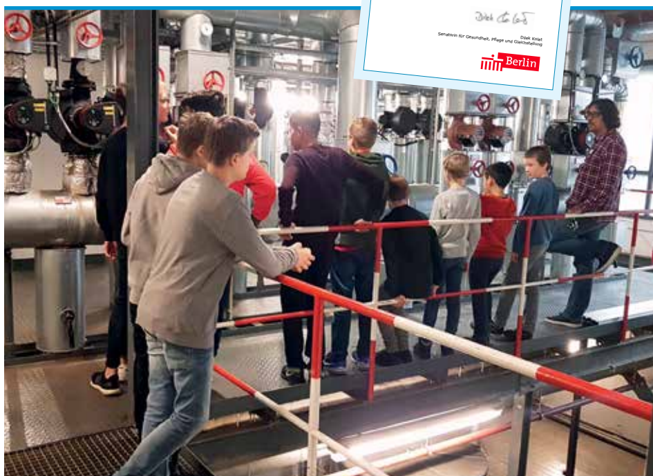
► Technische Anlagen im Paulinenkrankenhaus
